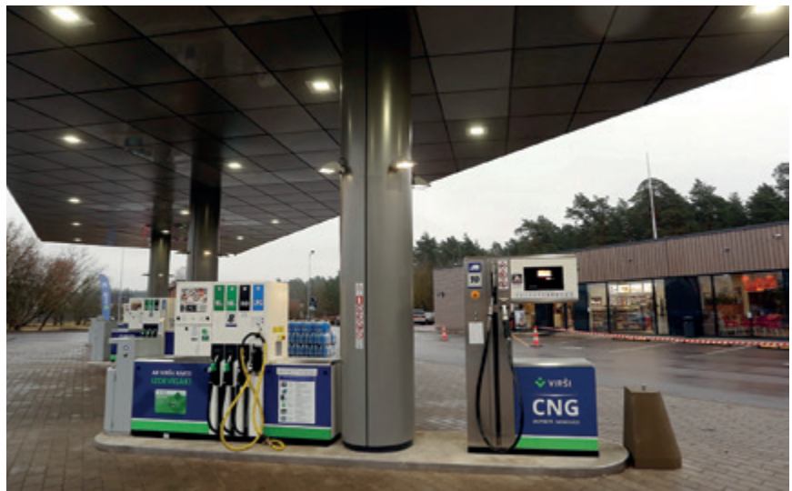
Viena no degvielas mazumtirgotāja “Virši – A” CNG uzpildes stacijām
