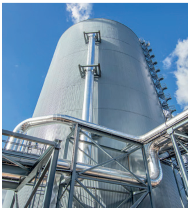
Siltumenerģijas akumulācijas tvertne Rīgas TEC-2 kompleksā, 2021. gads
